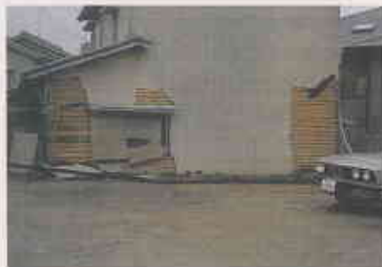
隅角部のモルタル壁の剥落
