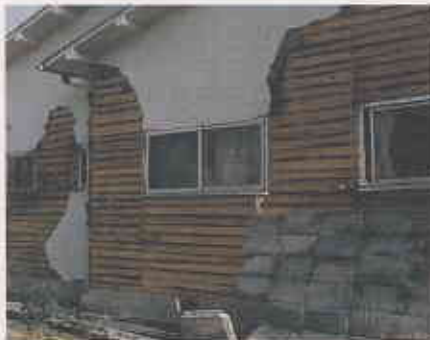
モルタル壁の剥落
