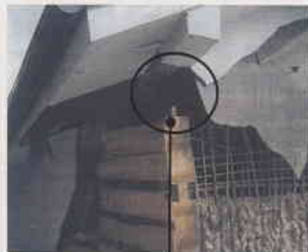
柱と桁の接合部の不良
