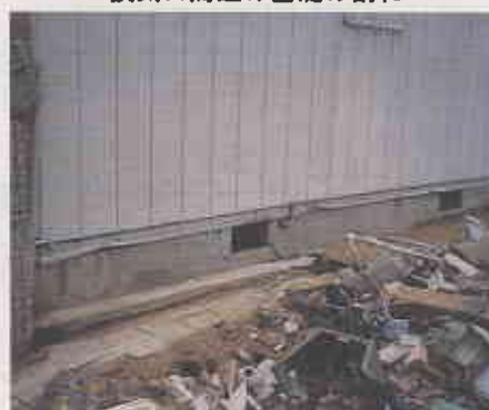
換気口周辺の基礎の割れ
