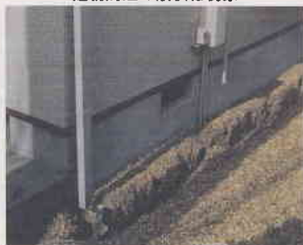
建物周辺の液状化現象
