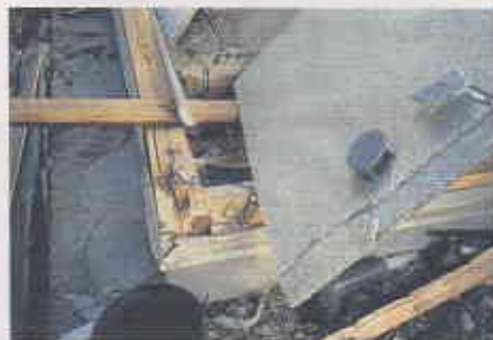
隅土台部分。アンカーボルトが接合不良
