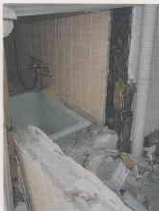
浴室廻りの柱の腐朽
