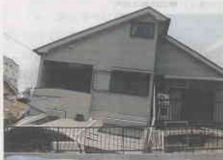
1階部分が完全に倒壊した新築住宅
