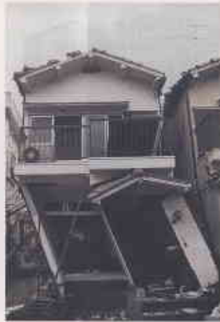
狭小間口住宅の被害（間口方向 の壁量が不足している）
