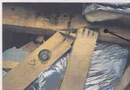
筋かいや柱の端部などの接合部の不良
