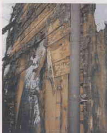
モルタル壁内の腐朽
