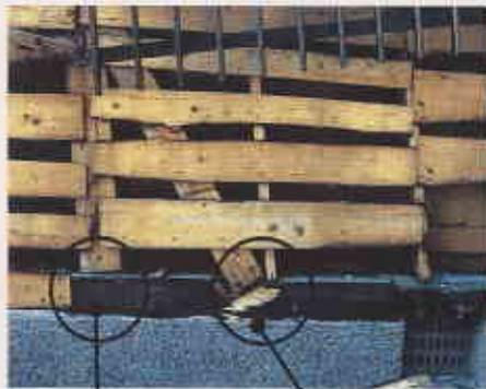
筋かいや柱などの端部接合部の不良
