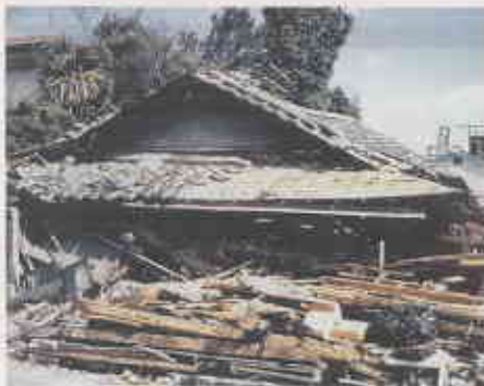
1階、2階ともに崩壊した住宅
