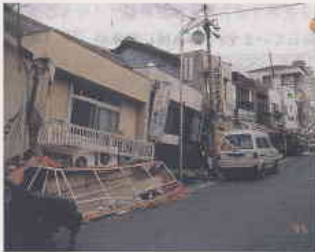
1階店舗開口部の耐力壁不足による倒壊 (店舗併用住宅)
