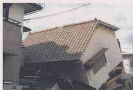
1階は全面開口の駐車場であり、耐力 壁の不足によって南側に倒壊
