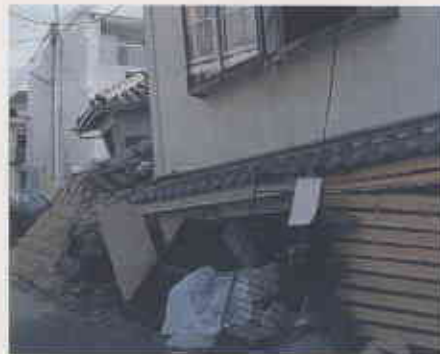
1階がガレージであり、耐力壁の配置 バランスの悪さによって1階部分が倒壊
