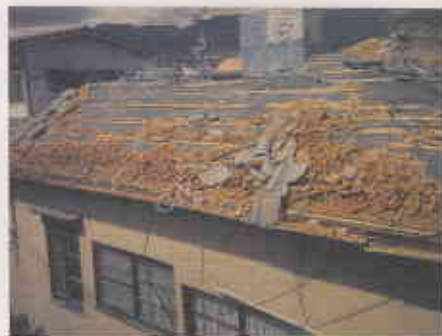
土葺き瓦屋根の被害状況
