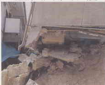
地盤崩壊に伴い、床から下が滑落
