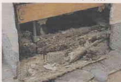
給水管まわりの土台等の腐朽
